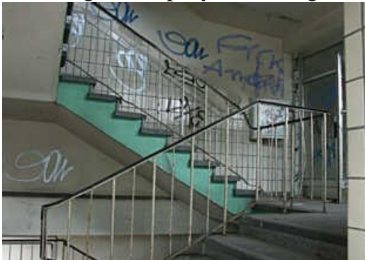
linik_innen5: das den oberen Flur abschließende Treppenhaus, heimgesucht von Schmierfinken, aber ansonsten noch relativ gut erhalten.
