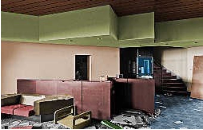
hotel_1innen2: die Rezeption für Gäste „zweiter Klasse“, zwar leicht verwüstet aber noch weitgehend komplett
