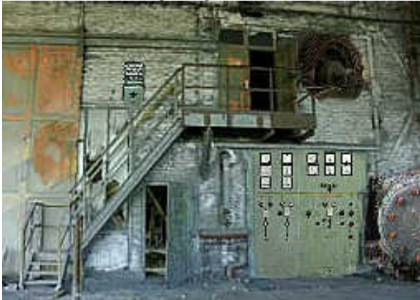
fabrik-innen315: eine brauchbare Eisentreppe, die nur noch auf ihren Abbau wartet.....
