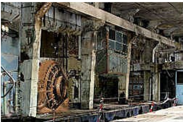
Zukunftshalle-innen7: in diesem Raum der Halle wartet noch viel Arbeit, die Außenwand ist teils mit Schimmelpilzen befallen
